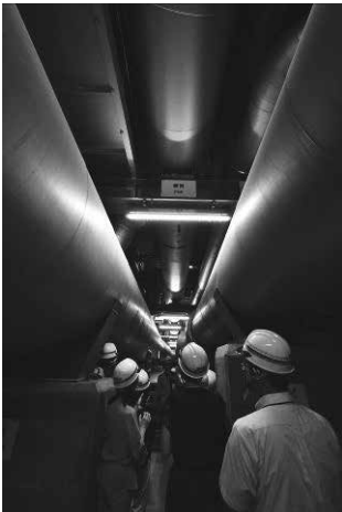
地域洞道内の地域配管路
