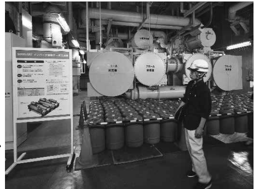
最新の電動ターボ冷凍機
